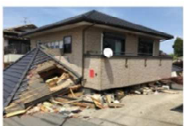
1階部分が完全につぶれている状況
