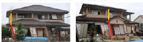
1,2階の柱変形があるが、倒壊していない建物
